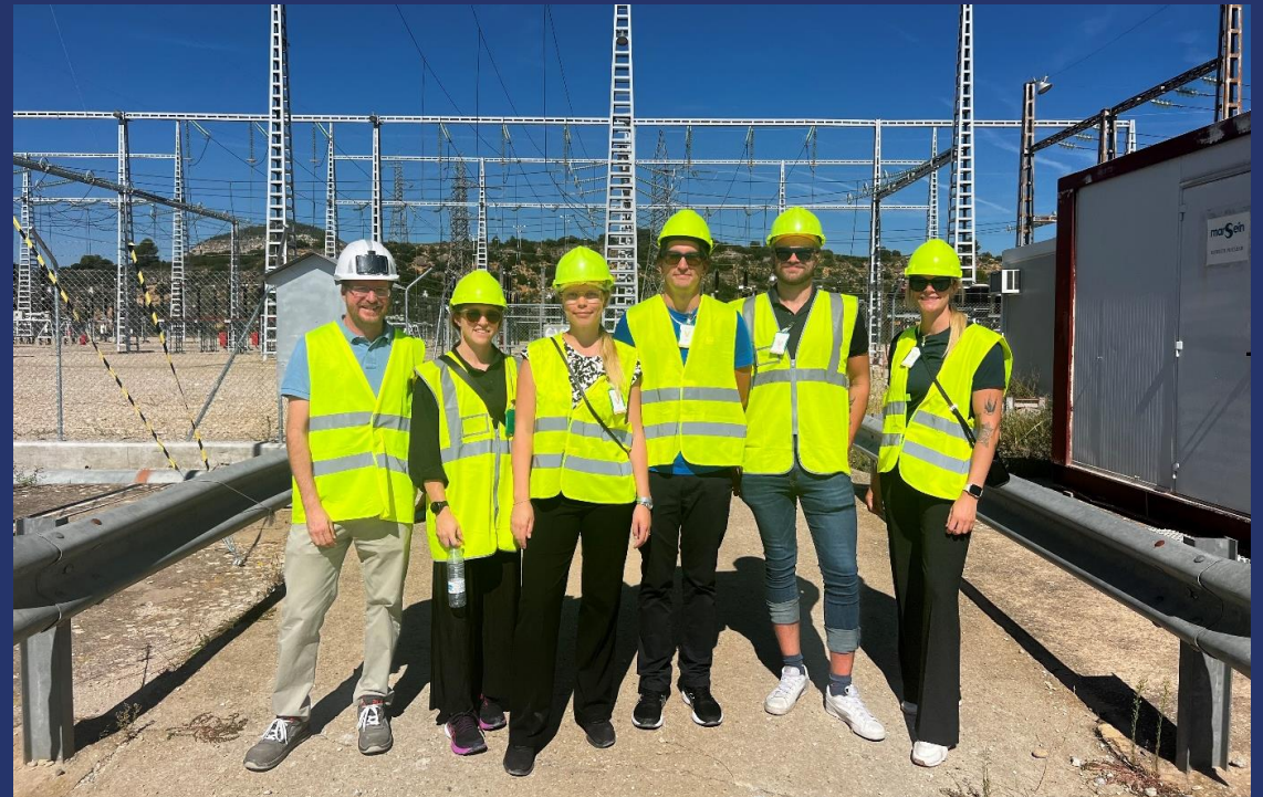
Framför ställverket på José Cabrera siten. Ställverket ska inte att avvecklas i dagsläget.
