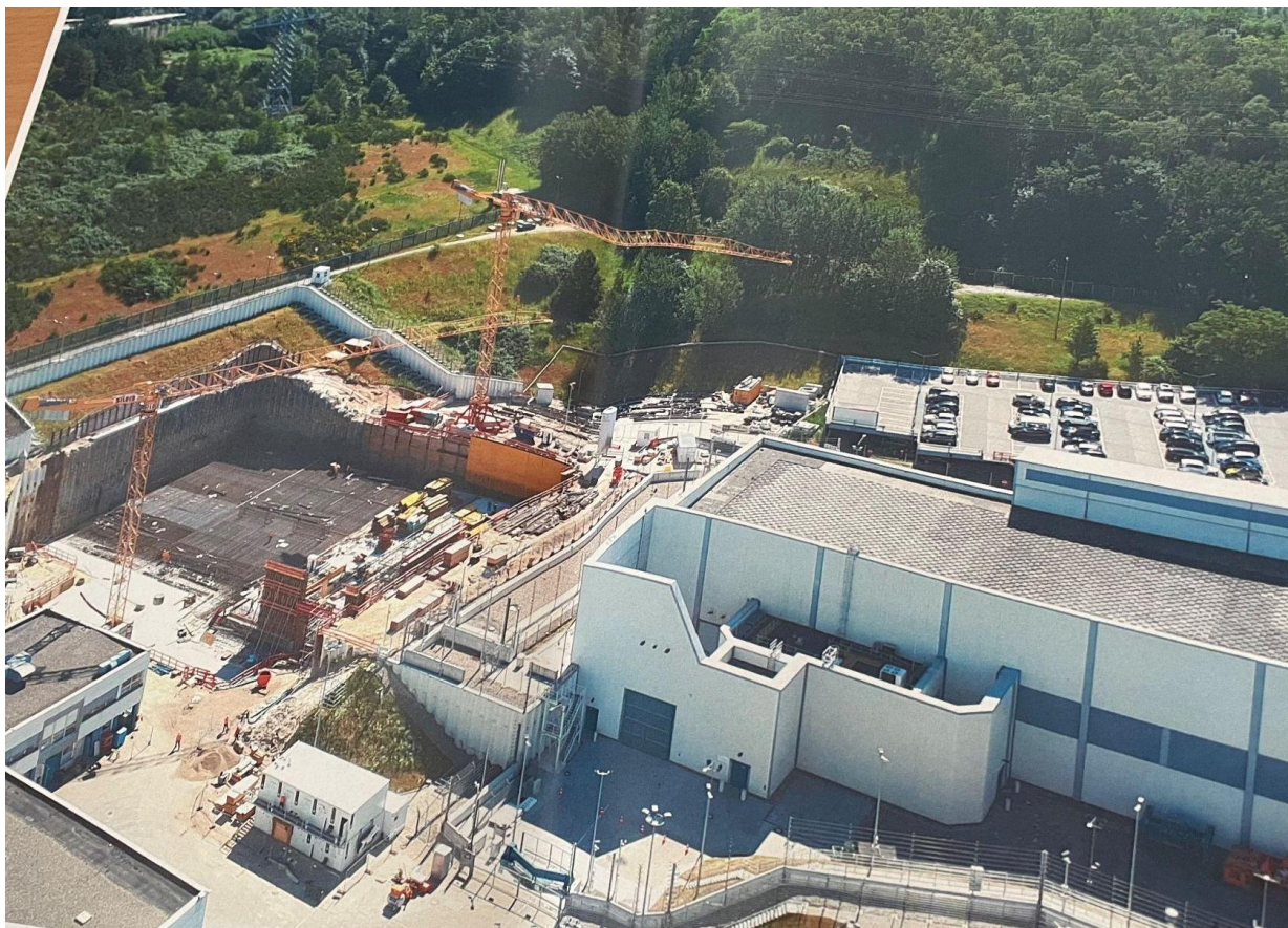
Byggnation av mellanförvaring lagret, till vänster syns vart de grävt och gjutit för grund. Till höger på bilden syns bränsleförvaringsbyggnaden.
