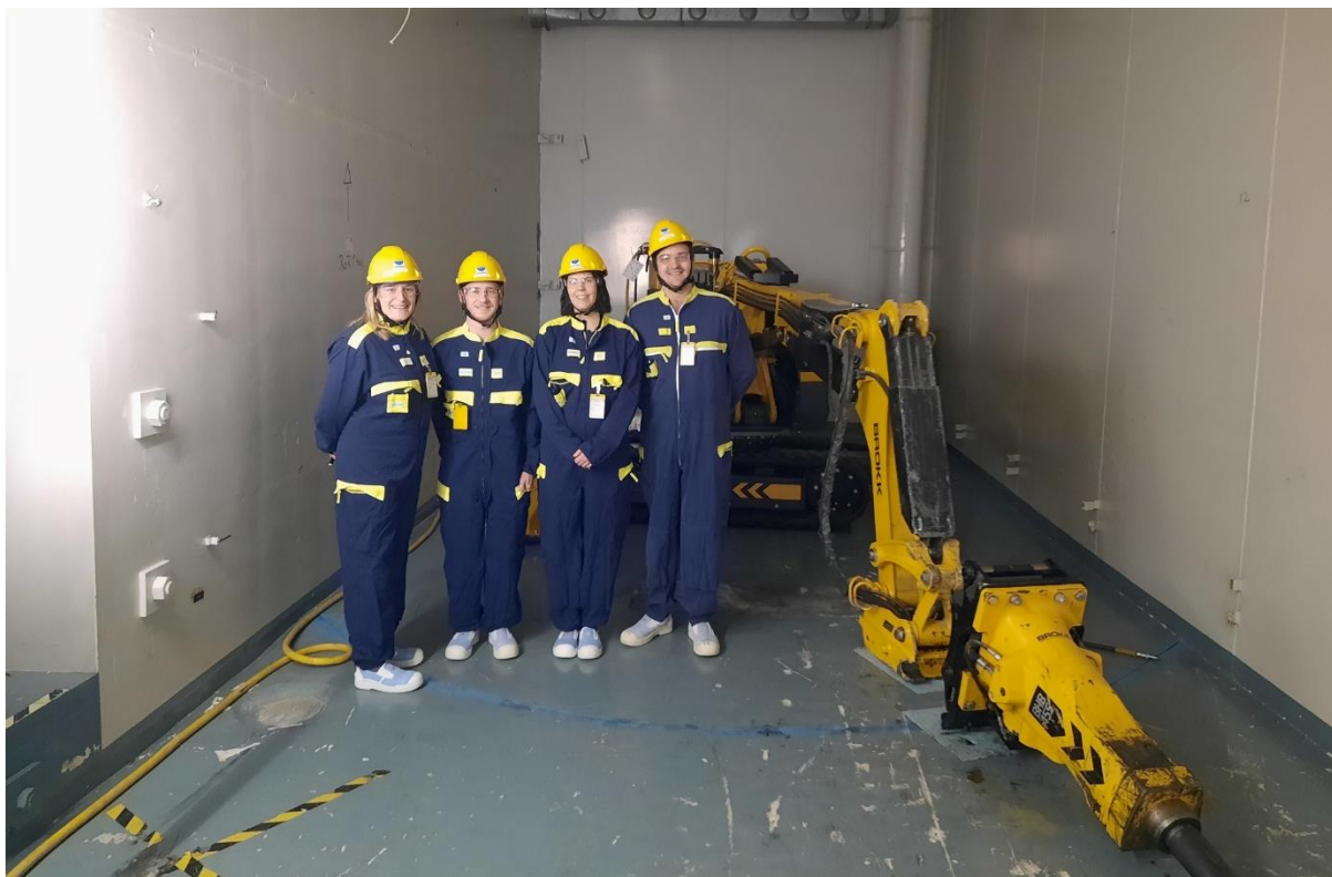
Julia, Marcus, Linnéa och Simon brevid den gula "Brokken" ett verktyg som använts vid avvecklingen av Ågestaverket i Farsta. Bilden är tagit inne i ett av rummen i bergrummet där rivningen pågår.
